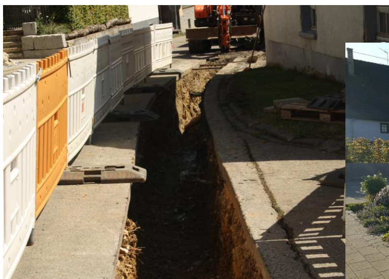
Abbildung 8: Das moderne Nahwärmenetz versorgt jetzt auch den Ortsteil Kreenheinstetten
