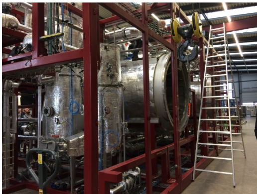
Foto 6: Im Bau befindliche Reinigungsanlage „MEGAVAC“; Bildautor: Landesamt für Geoinformation und Landentwicklung
