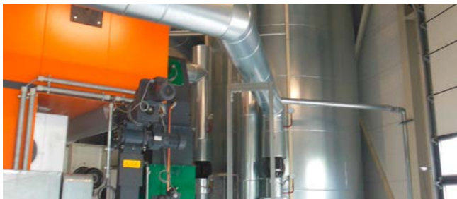
Biomasseheizzentrale und Pufferspeicher
